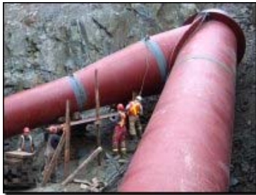
Mamquam Hydro Project
